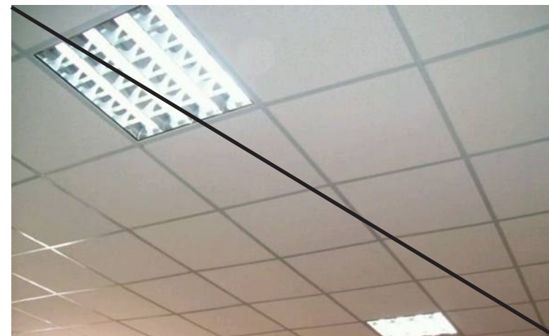
Плохо Открытые направляющие
